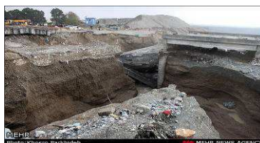
شکل (۱): تخریب پل در جاده قدیم کرج در اواخر آبان ماه سال ۱۳۹۱ (خبرگزاری مهر)
