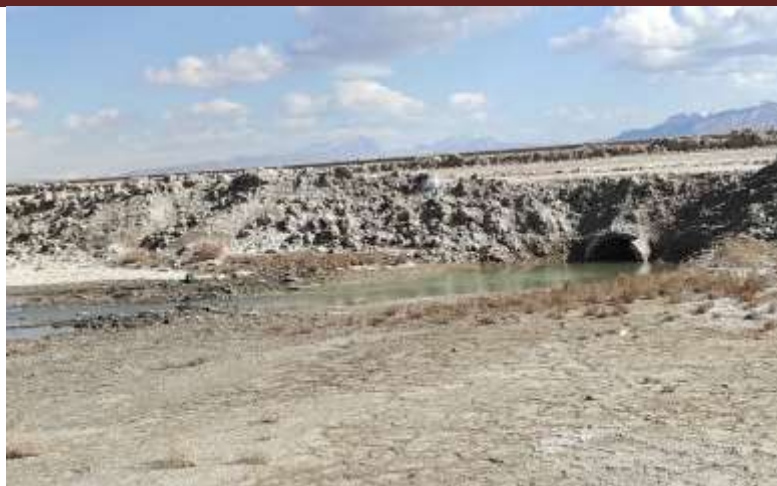
شکل (۳) ارتباط تالاب در دوطرف جاده از طریق لوله بتنی
