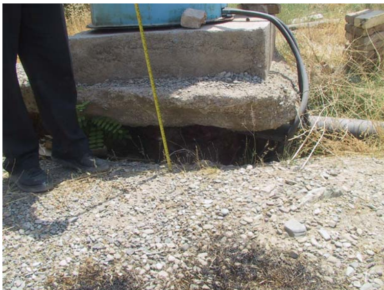
نگاره ۱-۲- نمایشی از اثر فرونشست زمین در اطراف چاه شماره ۳ در احمد آباد مستوفی ( حدود ۳۰ سانتیمتر نشست در بازه زمانی ۳ ساله )
